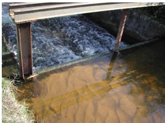
Dessableur au niveau du moulin de Batan
